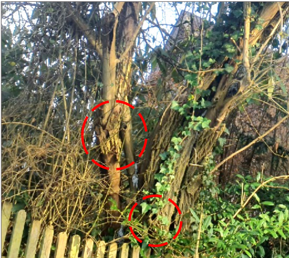
Abb. 9: Totholzbaum im westlichen Bereich der Gehölzreihe mit Astabbruchhöhlen geringer Tiefe und loser Rinde (rot markiert) (Aufnahmedatum: 09.12.2025)
